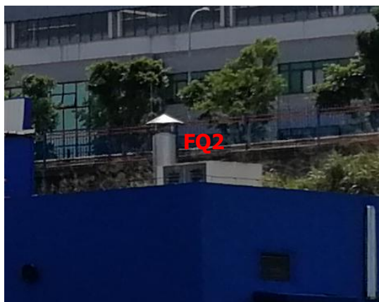
锅炉废气排气筒
