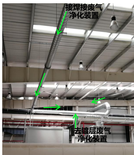
去镀层废气和焊接废气排气管
